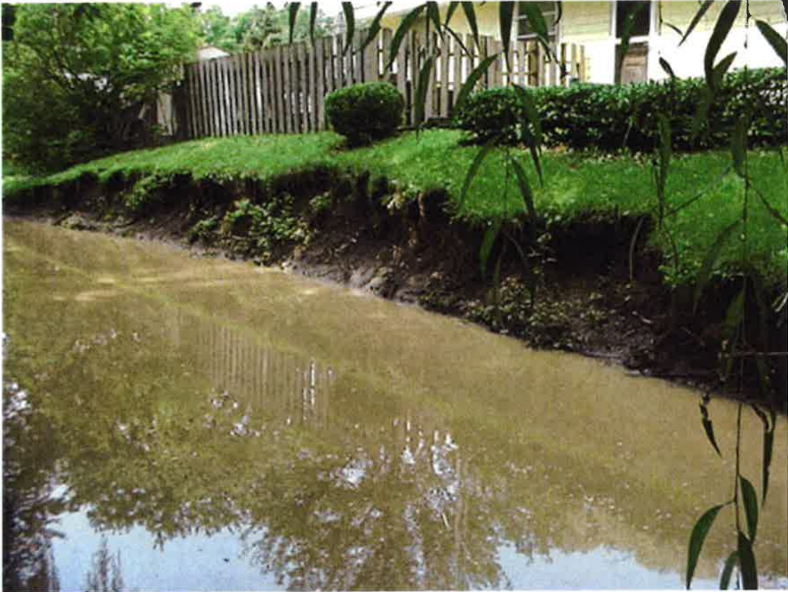
Klein Creek Erosion
